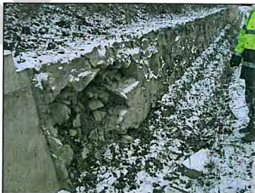
Degradări la elementele de consolidare
